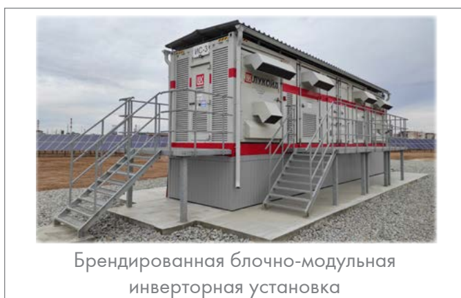
Блочно-модульная инверторная подстанция в климатическом контейнере
